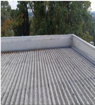
ancoragem na cobertura
