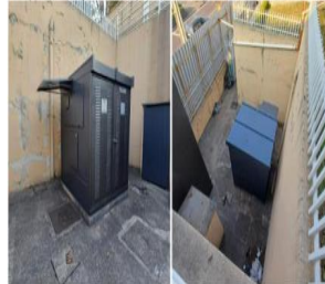
Caixa de entrada de energia
