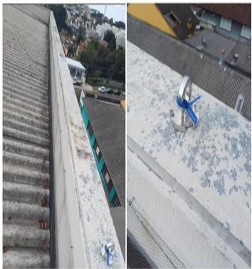
Ancoragem na cobertura
